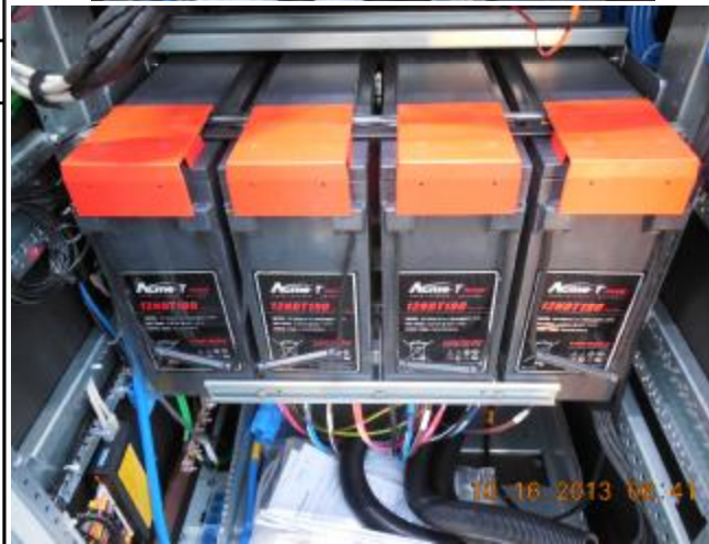
EXISTING BBU CABINET SCALE: N.T.S. 9
